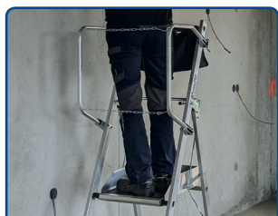
Protection de l'opérateur par garde-corps et chaînettes.
